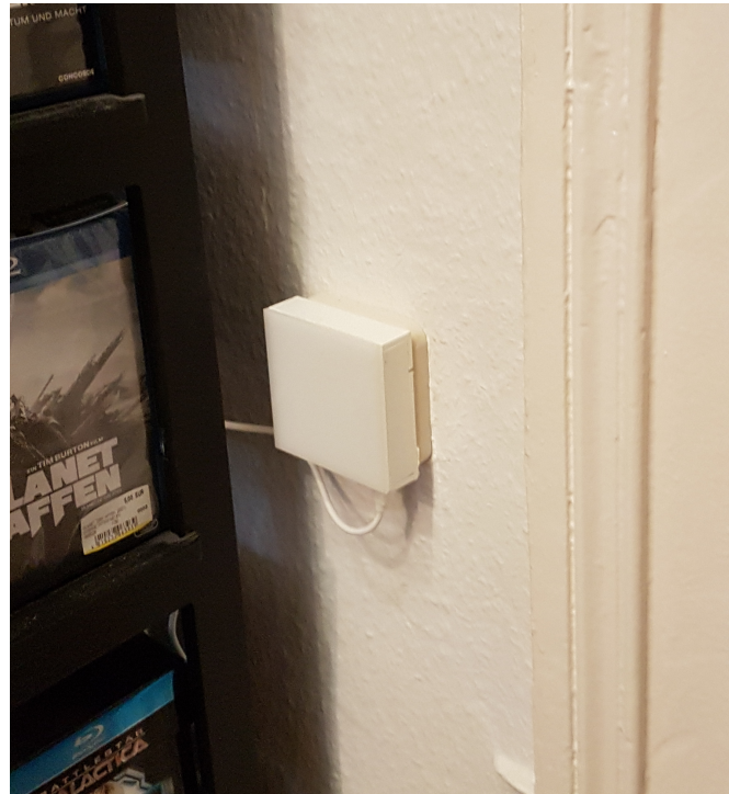
Abbildung 5.3: RCI an Wand angebracht
